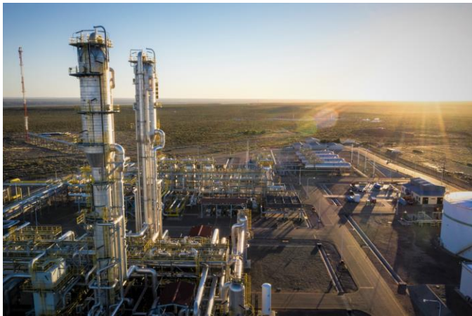
MEGA's Loma La Lata Plant
